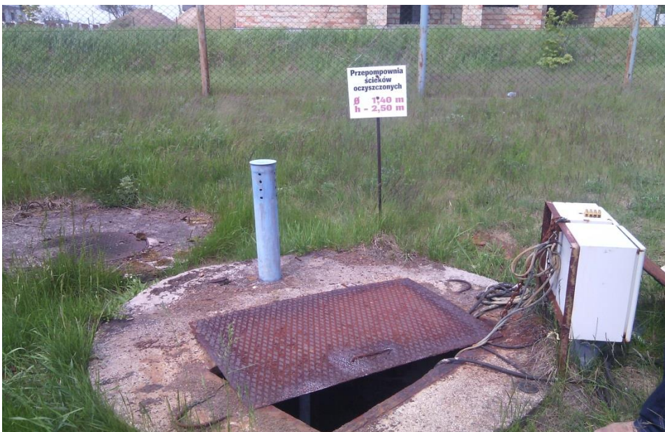
Fot. Nr 6. Przepompownia ścieków oczyszczonych
