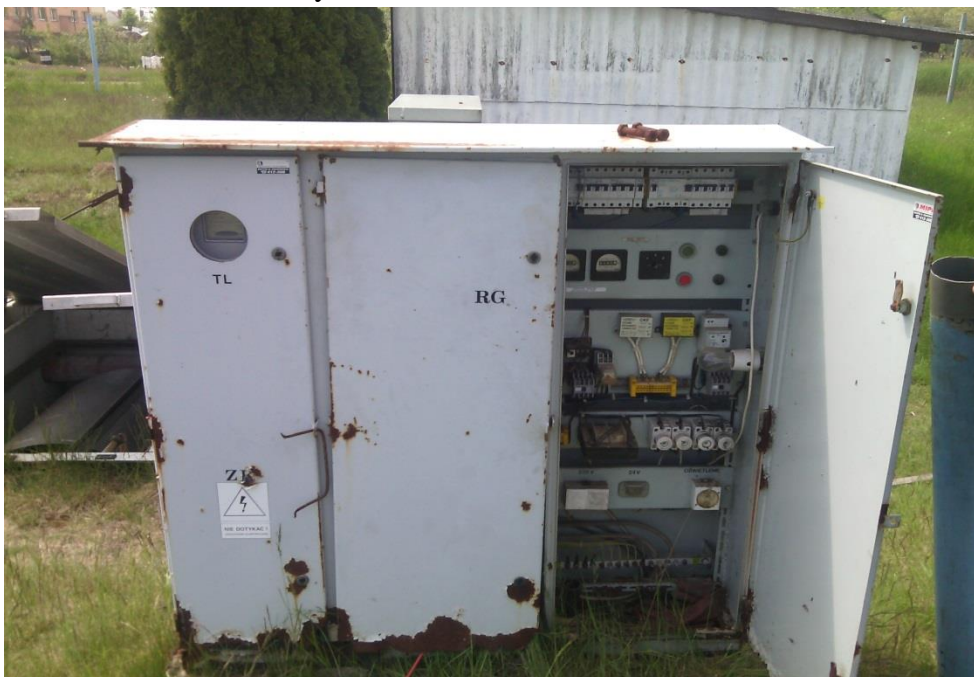
Fot. Nr 8. Tablica elektryczna
