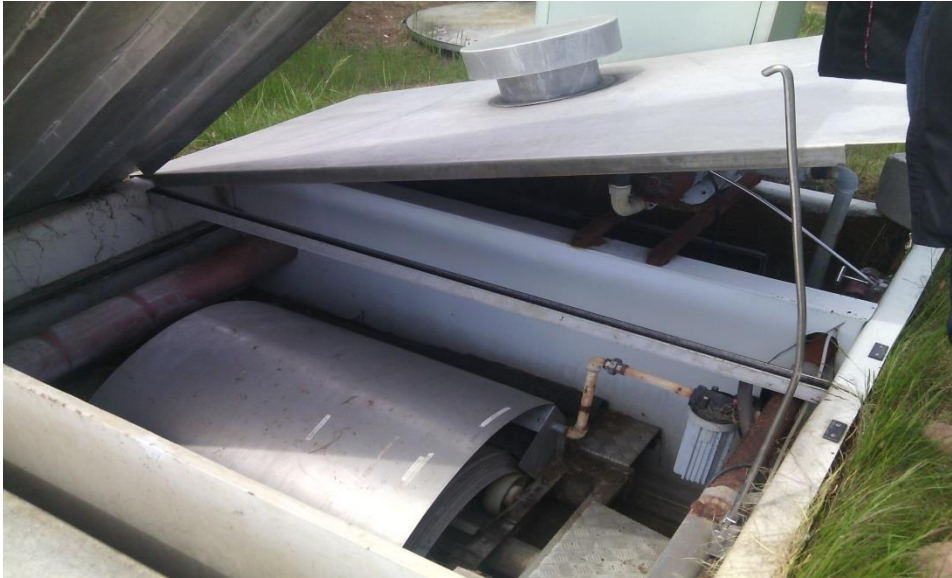
Fot. Nr 5. Rotofiltr
