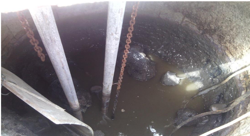
Fot. Nr 7. Przepompownia ścieków oczyszczonych
