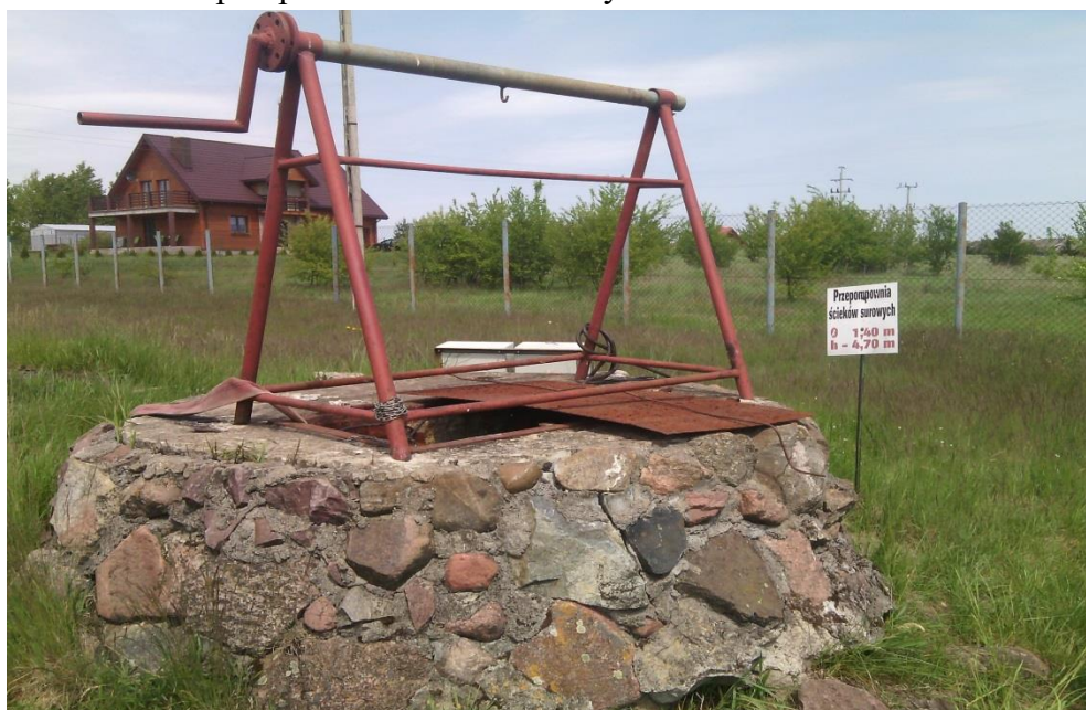
Fot. Nr 1. Przepompownia ścieków surowych
